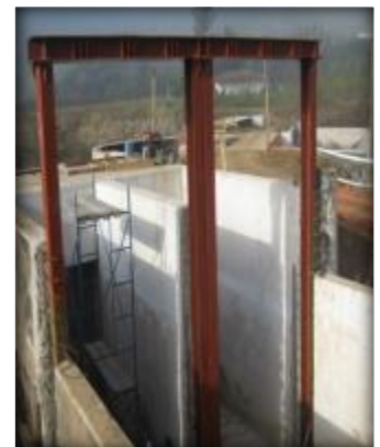
Insertos metálicos para compuertas.
